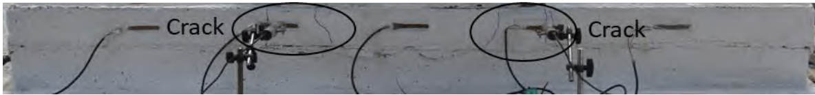
รูปที่ 5-18 บ่ารองรับรอยต่อพื้นสะพานที่ทดสอบด้วยแรงกระทำ 35% ของแรงกระทำสูงสุด (Ultimate Load) หรือแรงกระทำ 17.5 ตัน (ต่อ)
